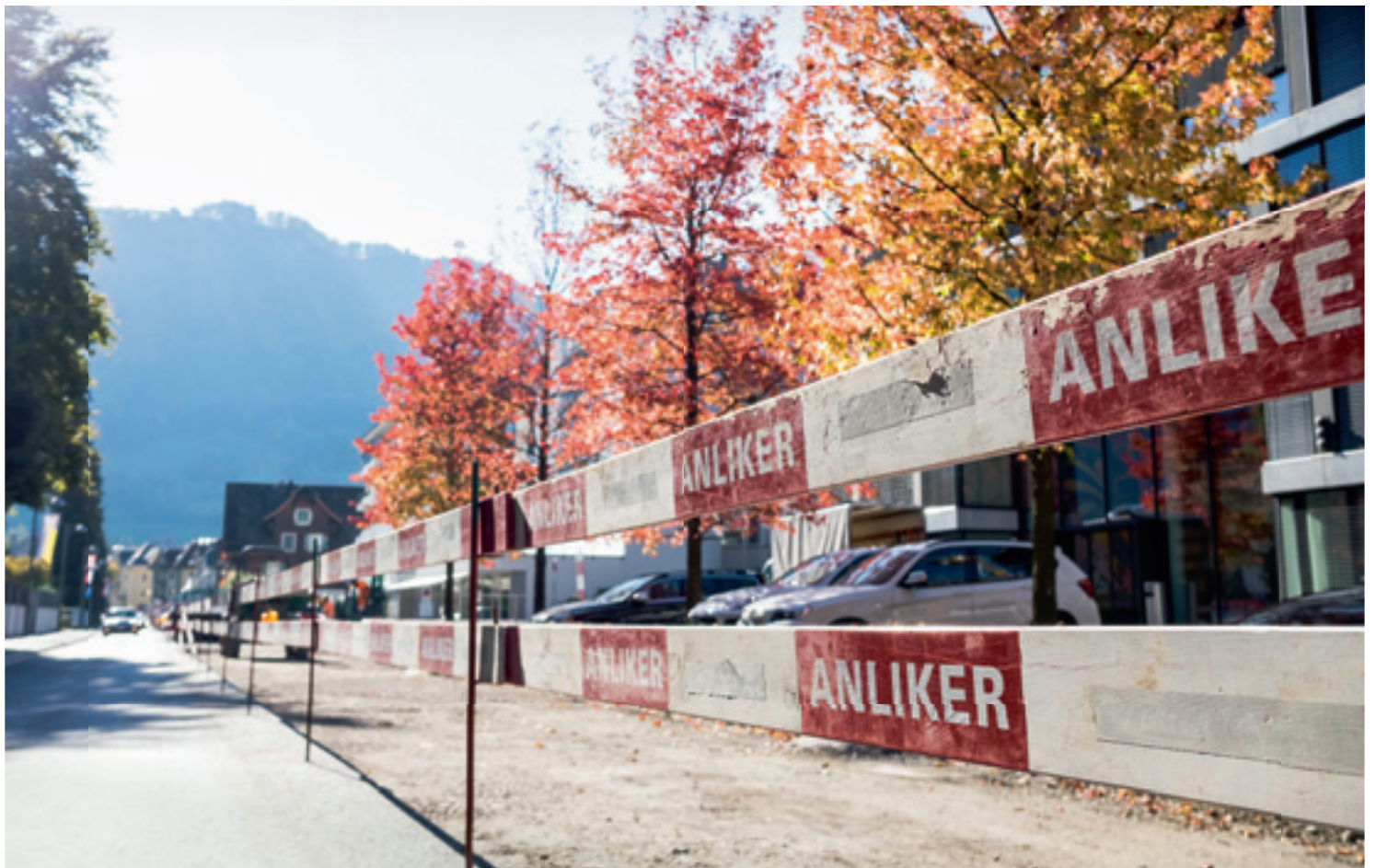
Oben: Vor dem Bau des Mehrfamilienhauses ist Mitte September 2017 der Stall in der Käppelimatt abgerissen worden. (Bild: wm)
