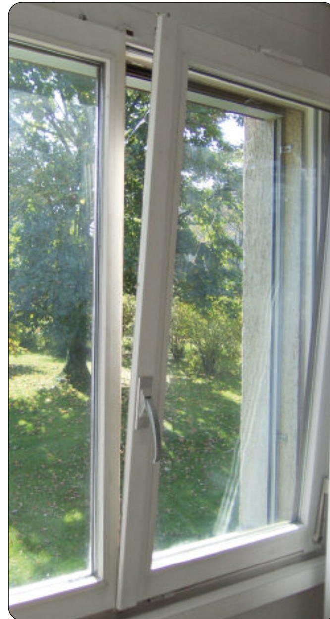
Dicke Luft: Gekippte Fenster nützen nichts. Die Heizwärme zieht direkt ins Freie.
