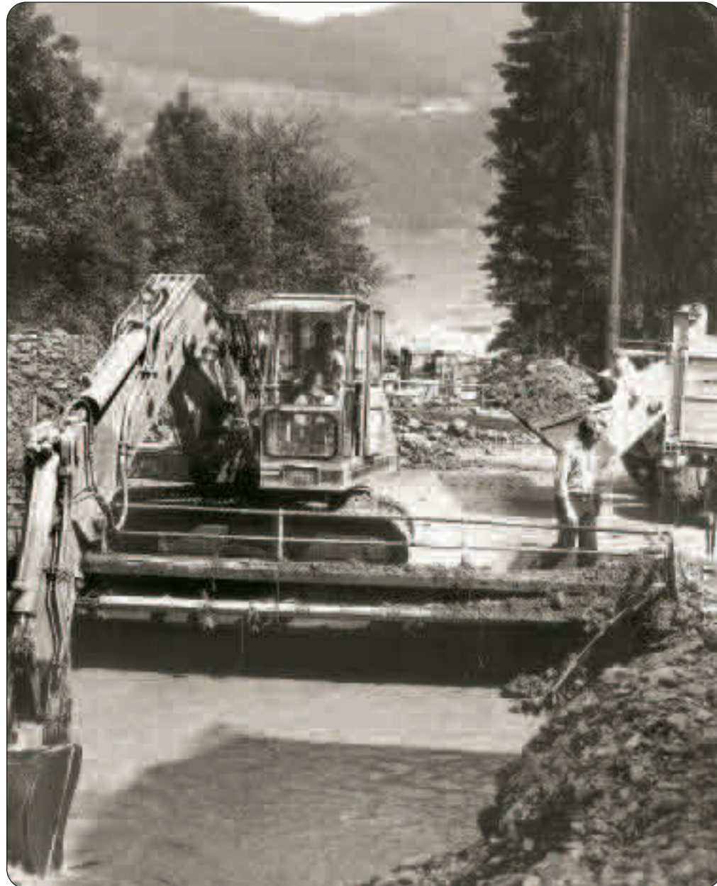
Unglück 1979: Die Steinibachbrücke an der Seestrasse wird zum Staudamm.
