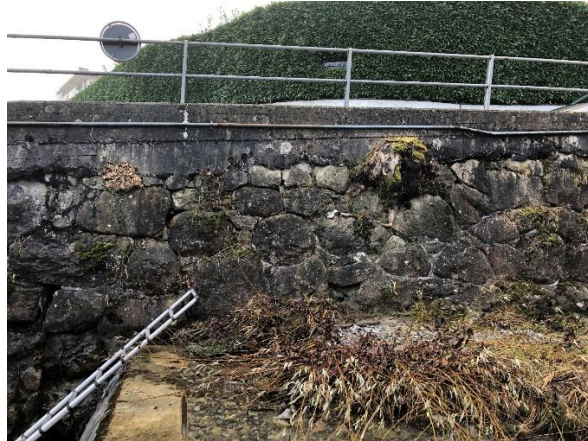
Abbildung 8: Bewuchs in Mauer.
