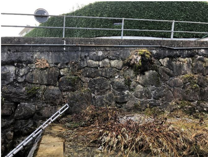
Abbildung 25: Bewuchs in Mauer.
