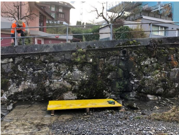
Abbildung 9: Risse in Fugen.
